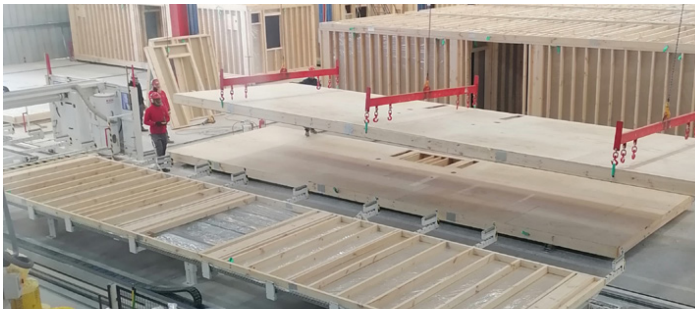
Figura 16. Tecno Panel, planta industrializadora
