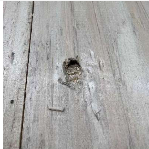
(d) Detalle de perforación producto del tornillo en CLT.
