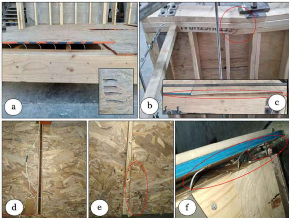
Fig 20. Modos de falla diafragmas comunes tipo SL, diafragmas con yeso cartón y con patrón optimizado. (a) fallo de SL-OSB, (b) y (c) fallos de SL-PLY, (d) apertura inter-panel para SL-OSB y SL-OSB Optimized, (e) modo de falla en bordes de paneles en SL-OSB Optimized y (f) fallas dúctiles de clavos y falles frágiles de tornillos en SL-PLY/GWB.
